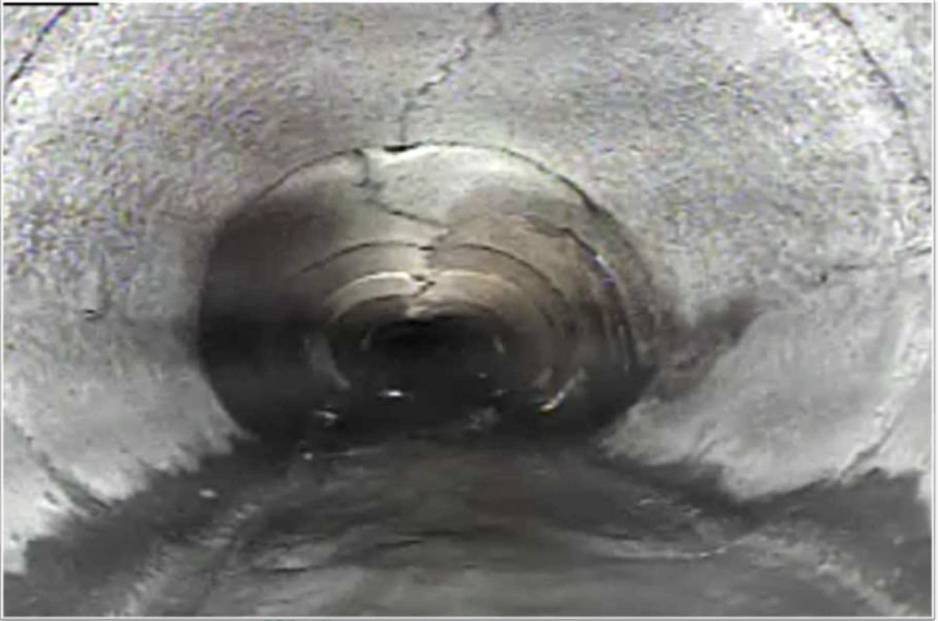
COLECTOR 8: FRACTURA LONGITUDINAL EN LA CLAVE DE LA TUBERÍA EN EL TRAMO DE AV. INSURGENTES Y TONALÁ, COL. ROMA, QUE EN CUALQUIER MOMENTO PUEDE PROVOCAR HUNDIMIENTO EN LA VIALIDAD.
