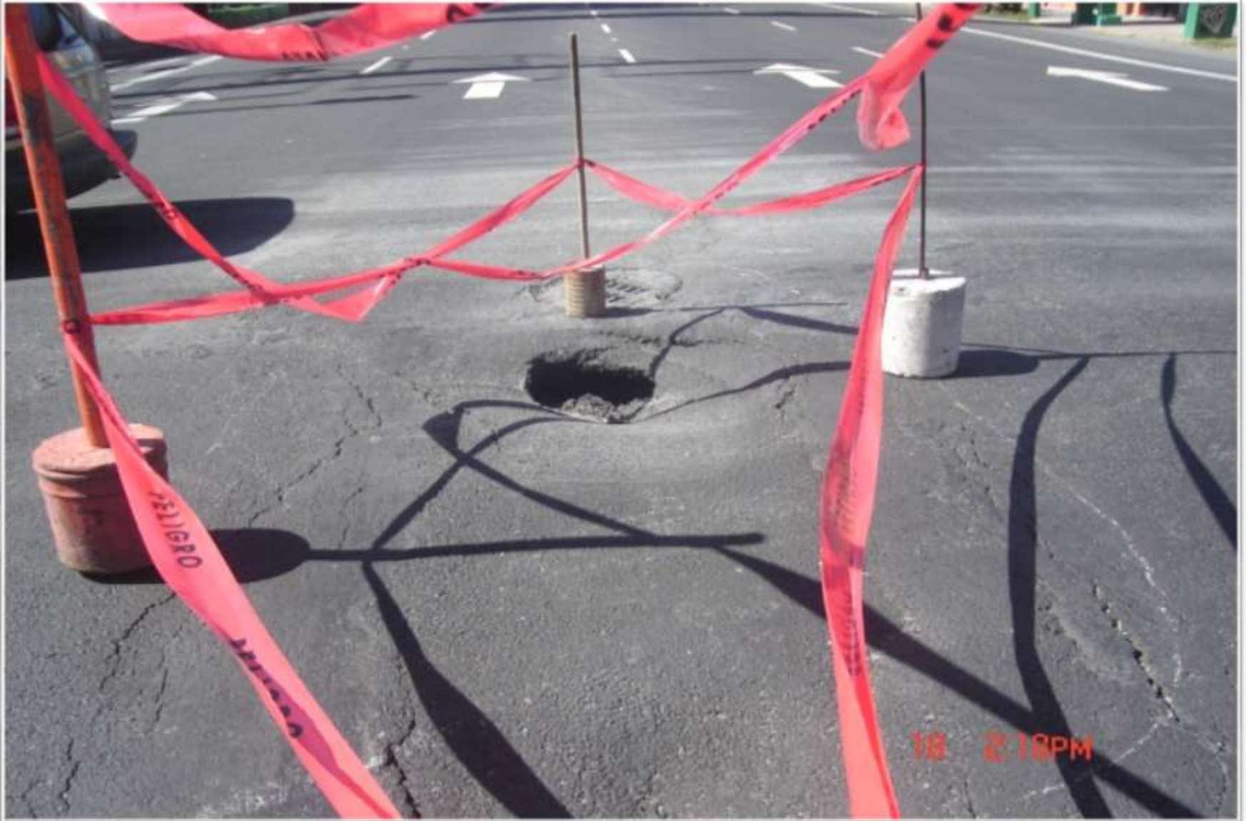
Hundimiento de terreno en vialidad por afectación del colector Montevideo, Colonia Lindavista, Deleg. Gustavo A. Madero.
