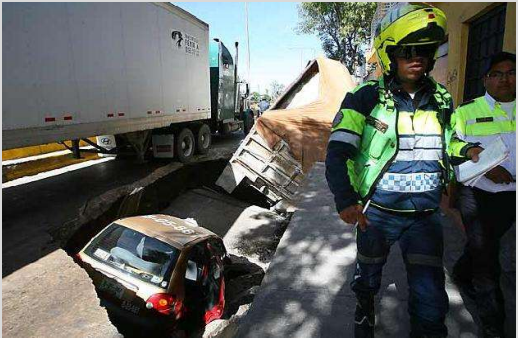
Hundimiento y afectación de vialidad por falla del Colector Norte 9, con daños a vehículos en la lateral Circuito Interior esq. Norte 80, Col. La Malinche, Delegación Venustiano Carranza.
