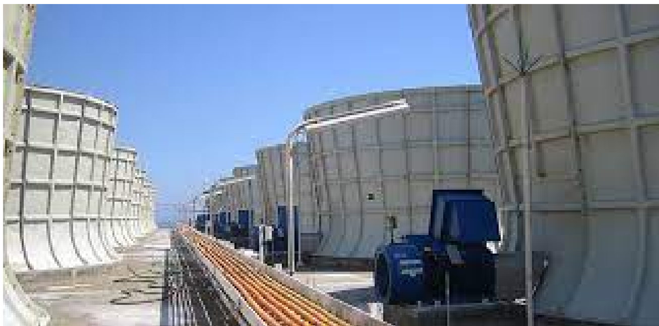
Tratamiento de Agua
